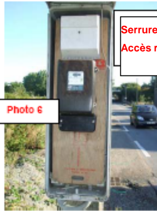
Coffret sur poteau, ouvert
