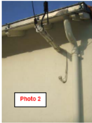
Câble de branchement, vu de près
